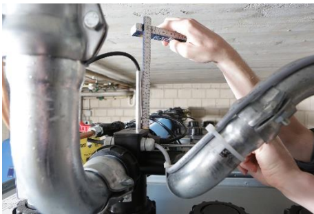
Die Füllleitung wird mit Sicherungsschellen gesichert und der Grenzwertgeber entsprechend den Vorgaben eingestellt.
